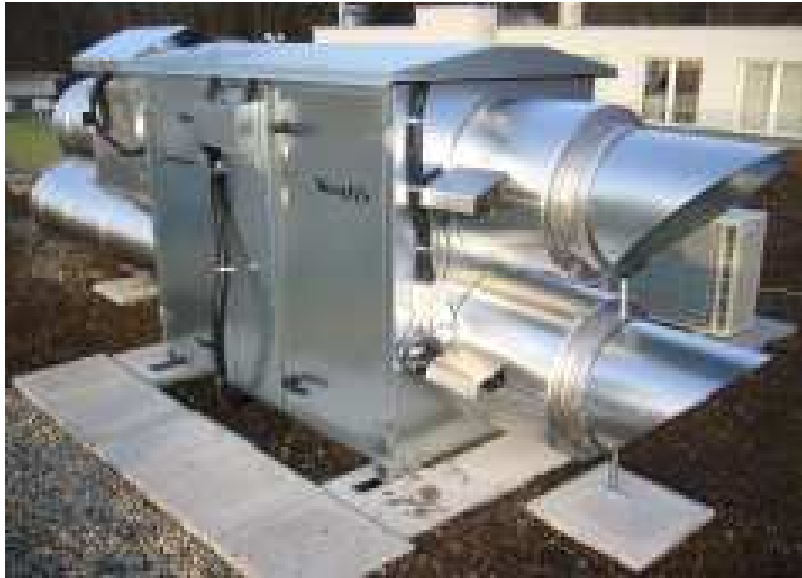
Alstom-Dättwil AHU mit Rot.WT. + Regulierung
