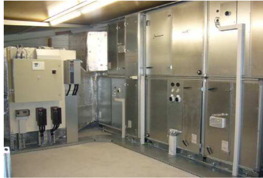
Catering- Rümlang AHU mit eingeb. Inverter WP
