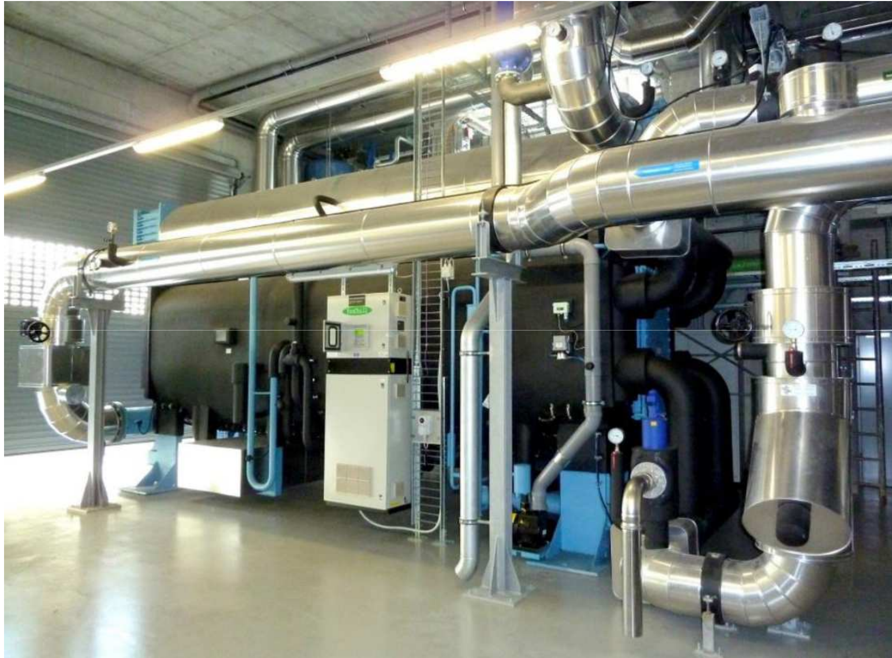
Referenzanlage: Stücki ,Powerbox Basel Doppelleffekt Absorptionskältemaschine
