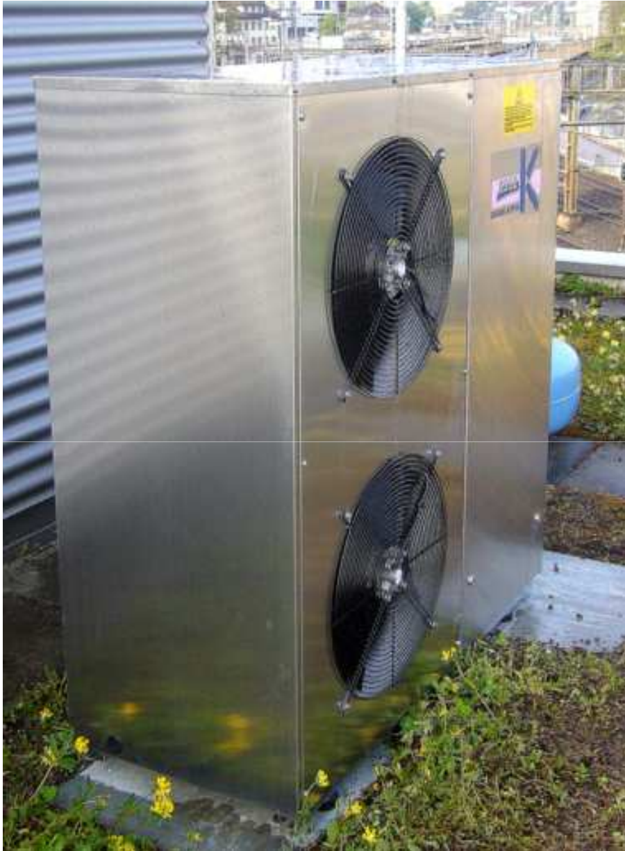
Amstein + Walthert Serverraumkühlung –Zürich
