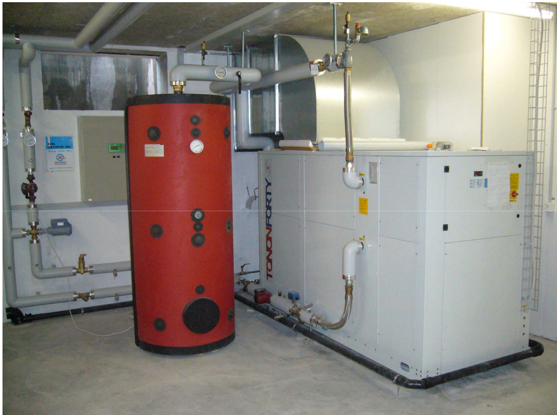
Fa .Künzi- Wangen Luft-Wasser Wärmepumpe
