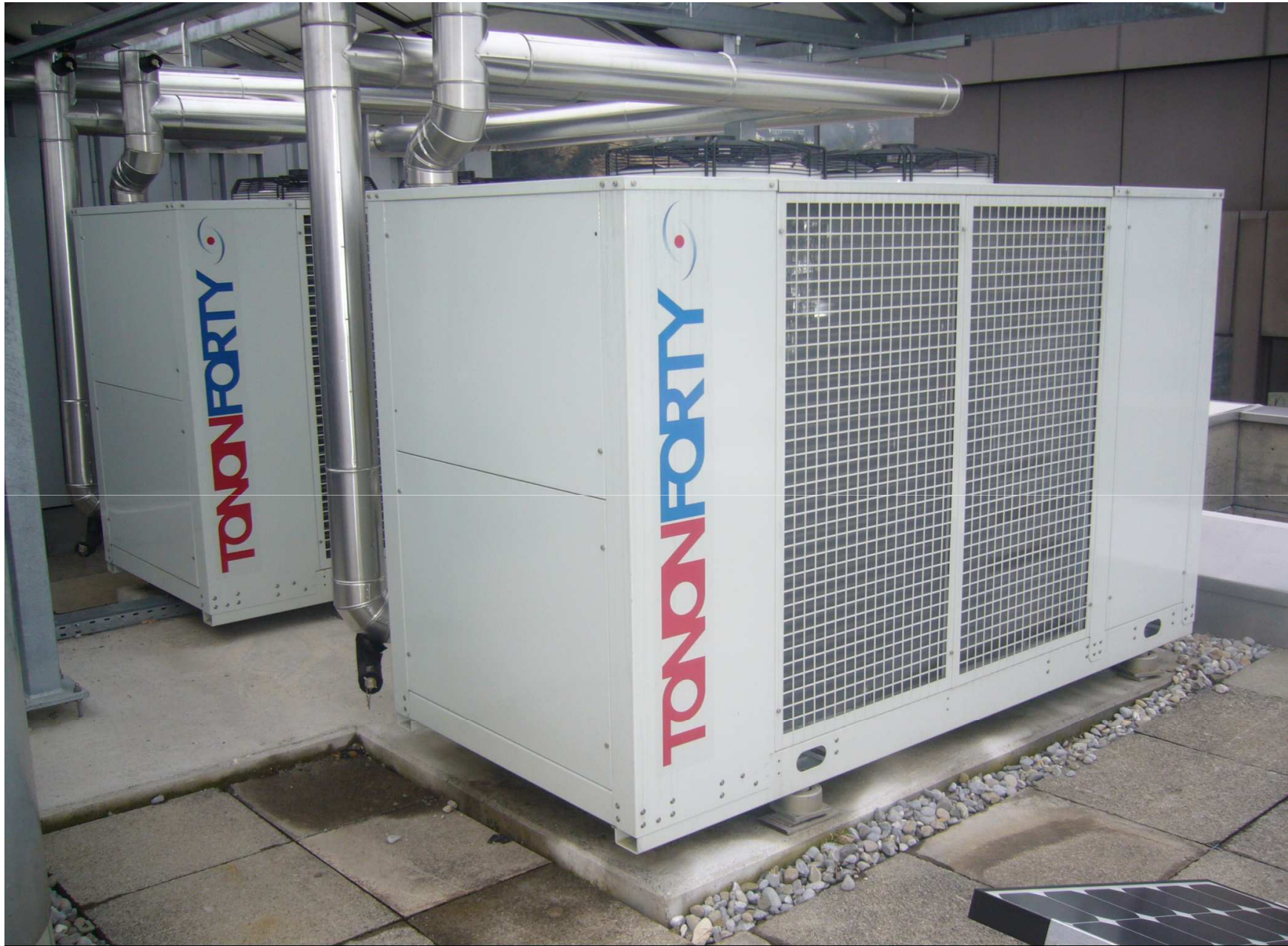
Zürcher Architektbüro – Zug Wärmepumpen
