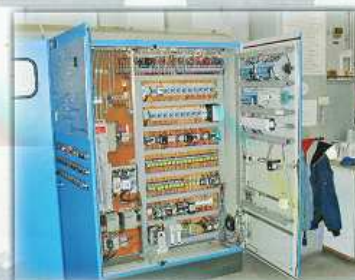
Moeller-Steuerung zur Abfallverbrennung
