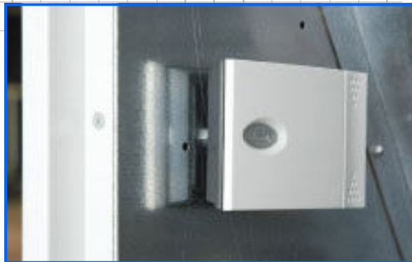
Dettaglio sensori di temperatura e umidità Feuchte- und Temperatursensoren
